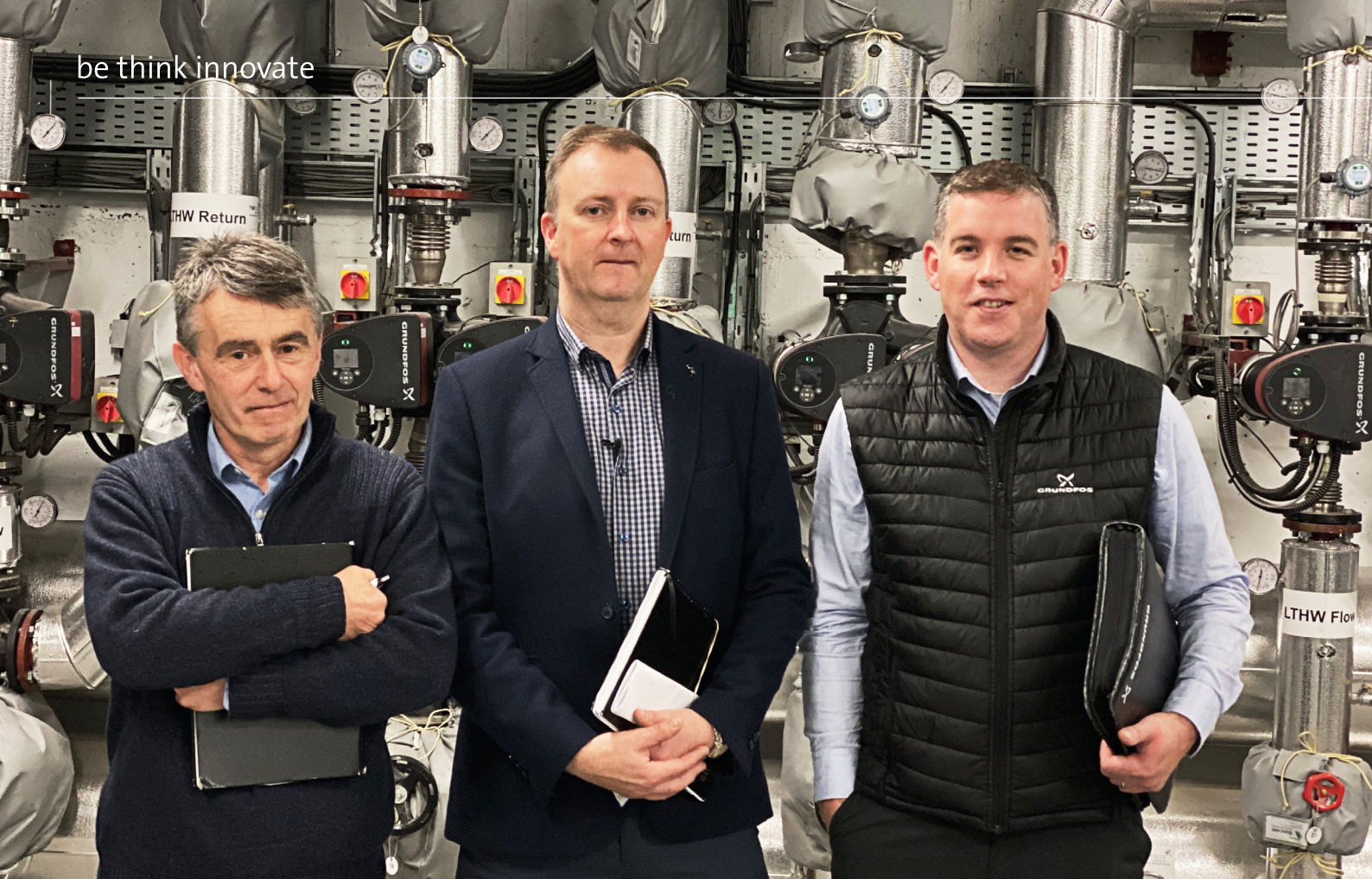
En partant de la gauche, Michael O'Brien et Declan McGoldrick du service immobilier de la direction des services de santé de l'hôpital universitaire de Sligo, avec Liam Kavanaugh de Grundfos Irlande dans la chaufferie de l'hôpital.
