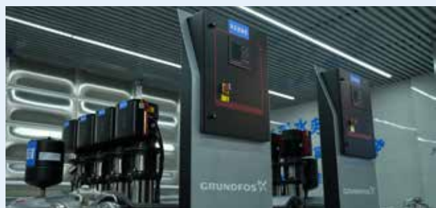
铂郡 A 区二供泵房作为该地区标杆示范项目
