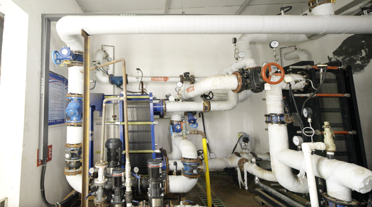
站内源泵及平衡管
